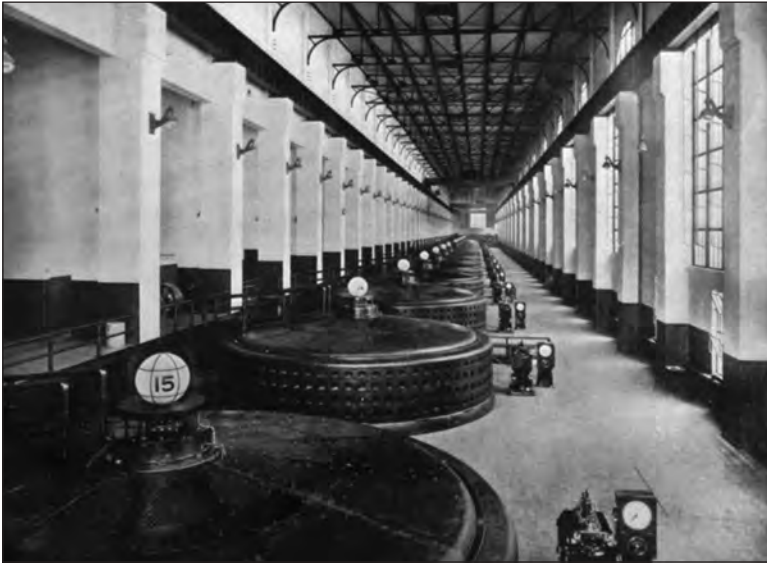
Fig. 7.8. Keokuk Generator Room
